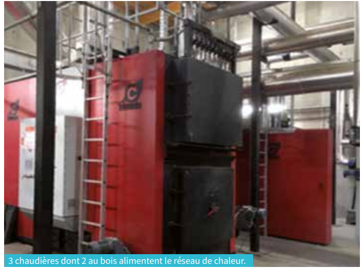
3 chaudières dont 2 au bois alimentent le réseau de chaleur.
